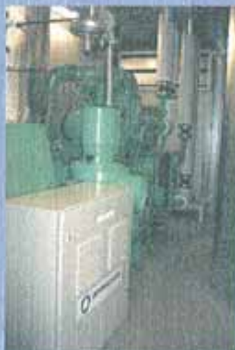
Gasmotoren på Sommersted Kraftvarmeværk
